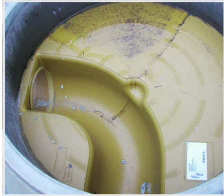
Abbildung 21 | Offenes Gerinne in Schachtboden
